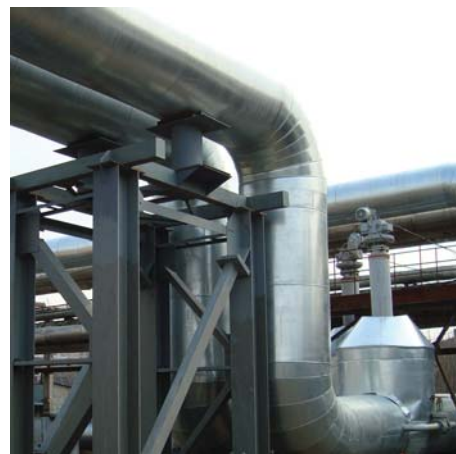
Системы вентиляции, кондиционирования и трубопроводы
