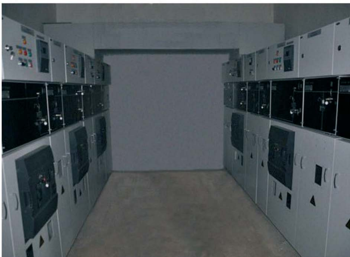
Рис. 2.1.9 Пример типового решения двухрядного распределительного устройства из ячеек КСО-207-Оскол с вакуумными выключателями на вводах и отходящих линиях
