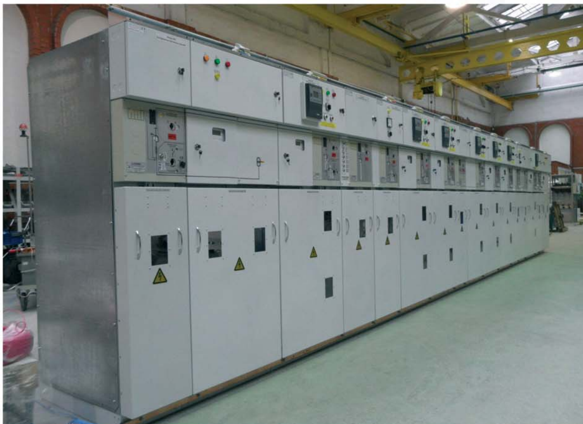
Рис. 2.1.8 Пример типового решения однорядного распределительного устройства из ячеек КСО-207-Оскол с вакуумными выключателями на вводах и отходящих линиях
