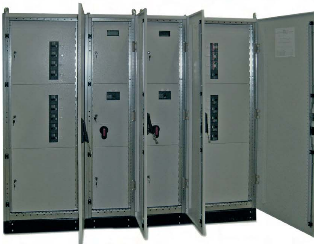
Рис. 3.2.2 ВРУ 1. Служебно-производственное здание Белгородской таможни по адресу: г. Белгород, ул. Победы, 78а
