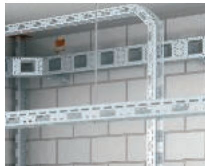
Монтаж мини-канала AZ Подвесной монтаж мини-канала AZ с помощью стержня с резьбой, а также переход из горизонтальной плоскости прокладки в вертикальную.
