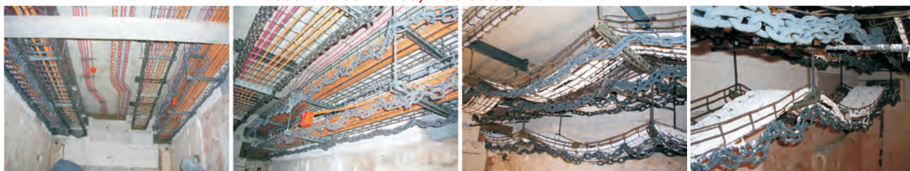
Вид перед и после проведения испытаний на огнестойкость кабельной трассы, выполненной из проволочных лотков
